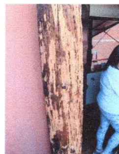
Foto 2: COLUMNAS DAÑADAS EN PÉRGOLA
