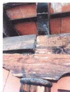
Foto 6: NECESITA REMOZAMIENTO DE CAPITELES EN PÉRGOLA DE MADERA
