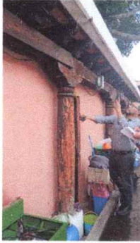
Foto 1: Toma de Medida de Columnas de Tienda en mal Estado
