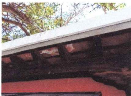
Foto 3: NECESITA REMOZAMIENTO DE VIGA DE SOPORTE DE PÉRGOLA
