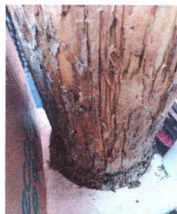
Foto1: COLUMNAS DAÑADAS EN PÉRGOLA
