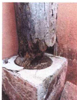
Foto 5: COLUMNAS DAÑADAS EN PÉRGOLA
