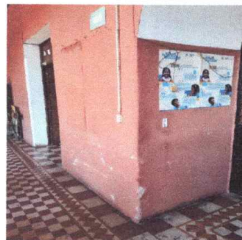
Foto 2: Pasillo Secretaría pintura en mal estado.
