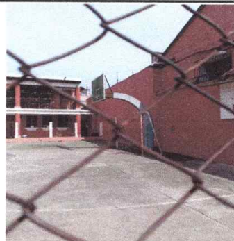
Foto 4: Pared Cancha Deportiva en mal estado
