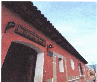
Foto1: Fachada Insol pintura en mal estado.
