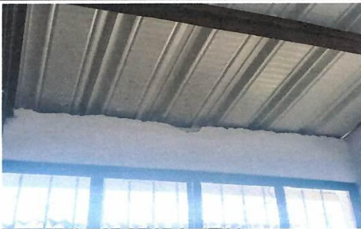
BAJA ALTURA DE LA PARED .
