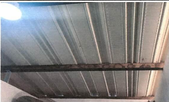
DETERIORO DE LA ESTRUCTURA DEL TECHO.
