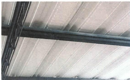
DETERIORO DE LA ESTRUCTURA DEL TECHO.
