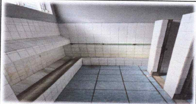
Foto 1: MIGITORIOS BAÑOS NIÑOS A LA B REEMPLAZO DE AZULEJO POR NUEVO
