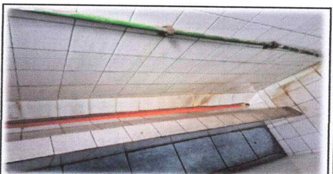
Foto 4: MIGITORIOS BAÑOS NIÑOS A LA B REEMPLAZO DE CONEXION DE TUBO DE PVC
