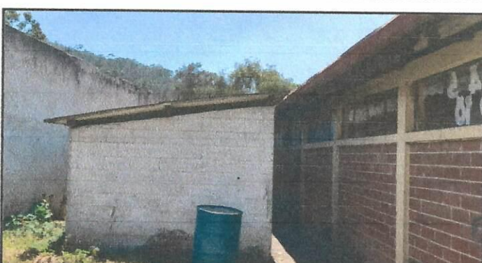
Foto 4: Vista lateral del cambio de canales y demolición de este cuarto que esta mal ubicado en el terreno. El techo y vigas estan totalmente dañados.
