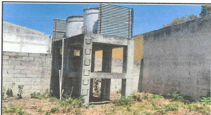
Foto 3: Depósito de agua que se demolerá, ya no es funcional y representa peligro para nuestros estudiantes.
