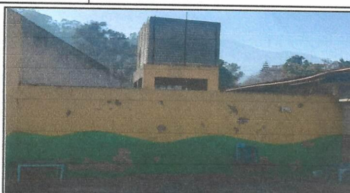
Foto 2: Demolición de esta pared para ampliar el espacio y también del tanque que se ve en la parte de arriba de la pared. Lo cual representa peligro para los estudiantes.
