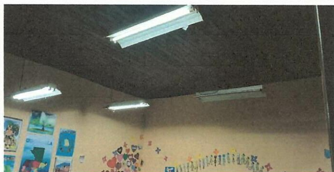
Foto1: Estado de las lamparas actuales de las aulas.
