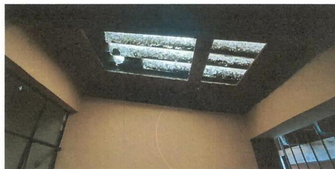
Foto 4: Lamina tragaluz en mal estado
