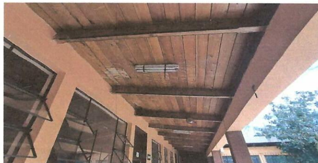
Foto 2: Estado de las lamparas ubicadas sobre el corredor
