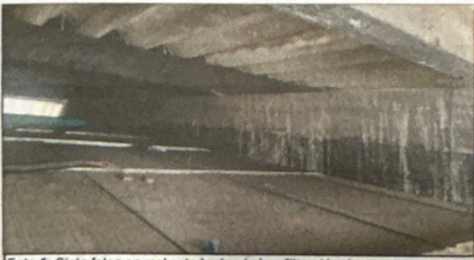
Foto 5: Cielo falso en mal estado donde hay filtración de agua.
