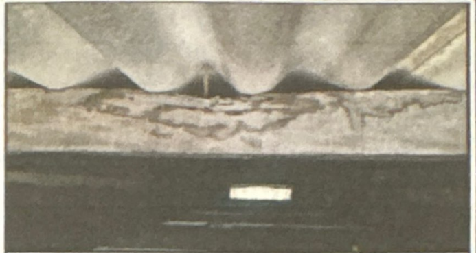
Foto 2: Madera que sostiene la lamina en mal estado.
