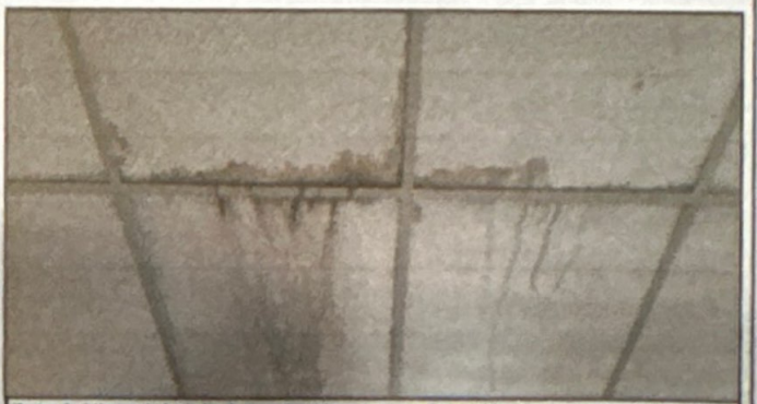
Foto 6: Vista del cielo falso donde se tiene filtración de agua por el mal estado de la lamina duralita.
