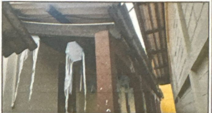
Foto 4: Canales en mal estado.
