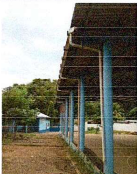
Foto 1: Se observa que los canales de la cancha se encuentra en mal estado
