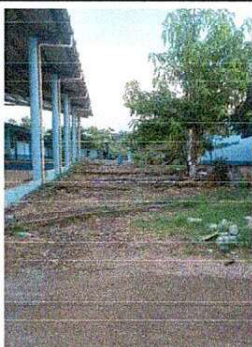
Foto 3: Se observa deterioro en los corredores de los salones de clases.
