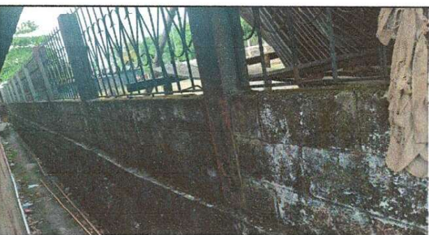
Foto 5: Se observa que el muro de contención requiere de repello.
