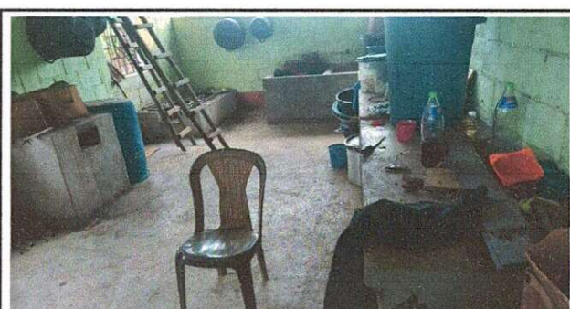
Foto 6: Se observa la falta de piso cerámico en área de cocina.
