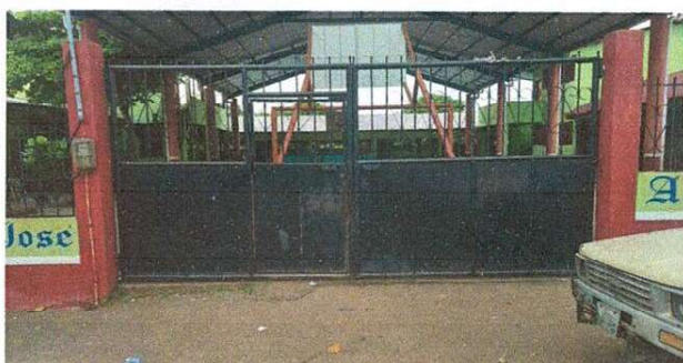
Foto 1: Se observa que el portón de metal se encuentra deteriorado por lo que requiere mantenimiento preventivo y correctivo.
