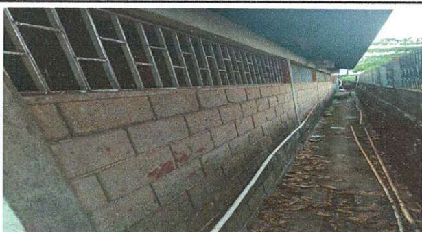
Foto 3: Se observa que los muros exteriores de aulas no cuentan con repello.
