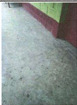
Foto 7: Se observa que no se cuenta con piso cerámico en corredor.
