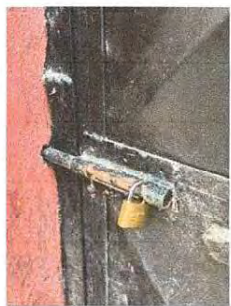
Foto 9: Se observa que no se cuenta con chapa en puertas.
