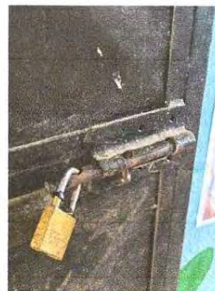
Foto 4: Se observa que no se cuenta con chapa en las puertas.
