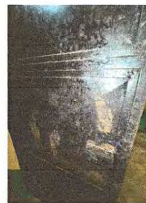
Foto 12: Se observa la puerta en mal estado.
