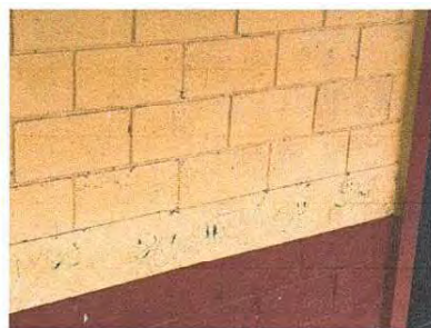
Foto 8: Se observa falta de mantenimiento de pintura en las paredes.
