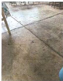
Foto 1: Se observa que no se cuenta con piso cerámico en las aulas.
