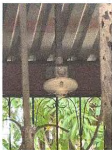
Foto 7: Se observa que no se cuenta con focos y el sistema eléctrico está dañado.
