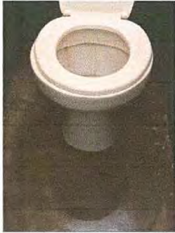
Foto 13: Se observa que el inodoro cuenta con fuga.
