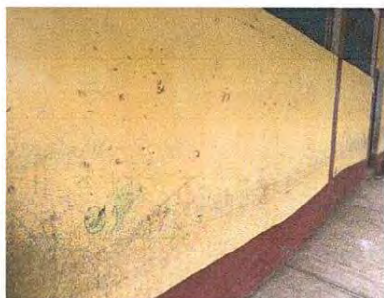
Foto 5: Se observa que las paredes se encuentran sucias, y requieren mantenimiento.
