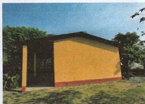
Foto 3: Se observa el módulo de No. 4 (costura), necesita sustitución de lámina
