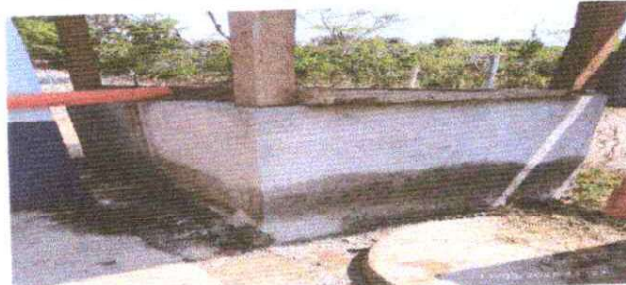
Foto 8. se observa la necesidad de suministrar e instalar azulejo a pileta de patio por dentro y fuera.
