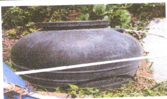
Foto 9: se observa la necesidad de sustituir el deposito de agua por uno más grande de 2500 lt
