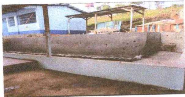
Foto 11: se observa la necesidad de suministrar e instalar barandas de metal en bordes de muro de contención.
