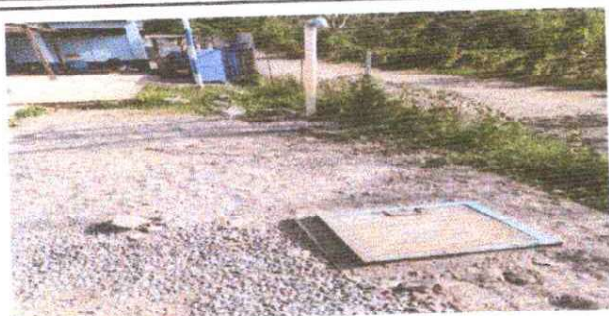
Foto 7 se observa la necesidad de darle mantenimiento a la fosa septica.
