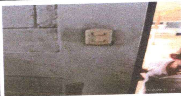
Foto 4: Se observa la necesidad de reparar toma corrientes y apagadores en aulas
