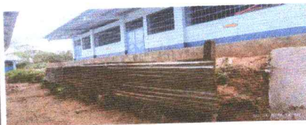
Foto 2: Se observa la necesidad de aplicar sabieta a muro de concreto ciclopeo
