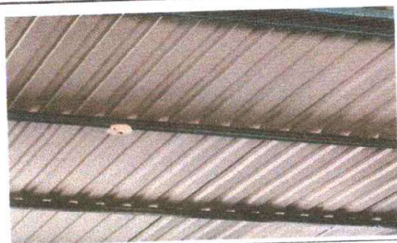
Foto 5: Se observa la necesidad de reparar luminarias de sistema eléctrico en aulas
