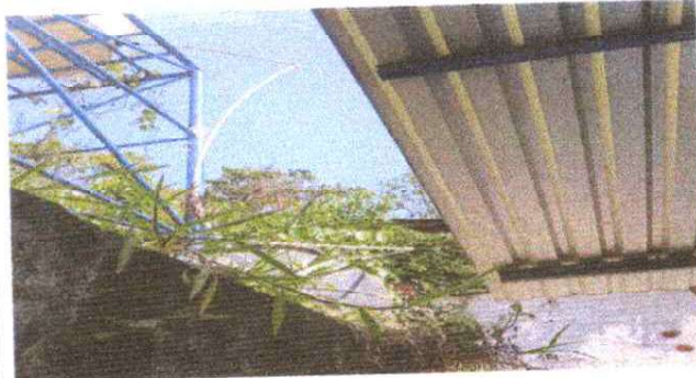
Foto 10. Se observa la necesidad de reparar la tubería principal
