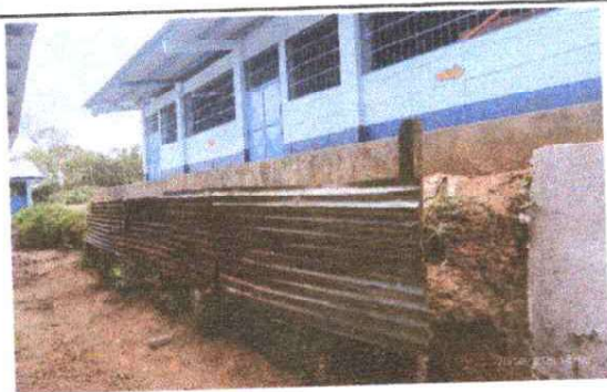
Foto 3: Se observa la necesidad de aplicar repello en muro de concreto ciclopeo
