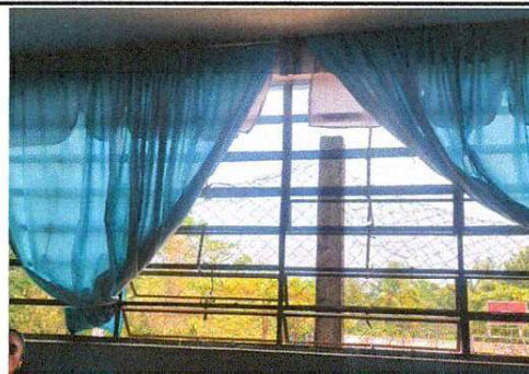
Foto 4: Se observa que no se cuenta con balcones en las ventanas.
