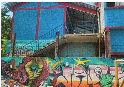
Foto 1: Se observa el mal estado la cerca de malla
