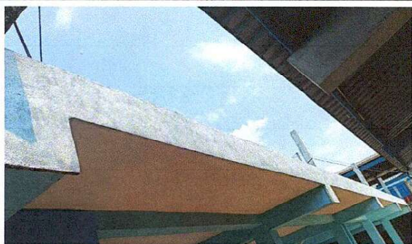
Foto 7: Se observa que no se cuenta con barandas en el área de salón de usos múltiples.
