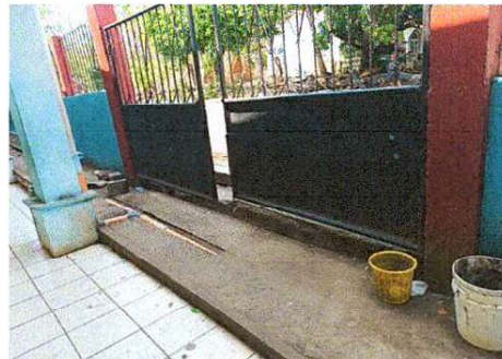
Foto 2: Se observa que el portón requiere de mantenimiento preventivo.
