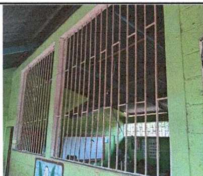
Foto 3: Se observa que los balcones requieren de mantenimiento.
