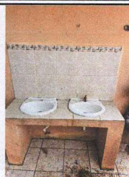
Foto 2: Se observa que los lavamanos no cuenta con artefactos, y se encuentran en mal estado, están inservibles
