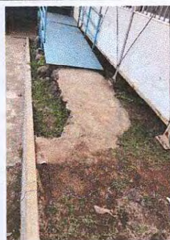
Foto 10: Se observa que la torta de concreto de la entrada del aula se encuentra en mal estado y genera accidentes
