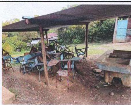
Foto 4: Se observa que la pila no cuenta con una torta de cemento y al momento que llueve o se usa la pila se forma mucho lodo
