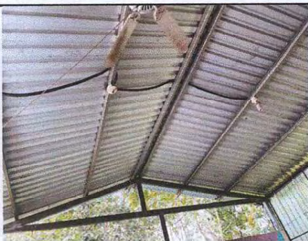
Foto 9: se observa que la escuela no cuenta con buen sistema electrico
