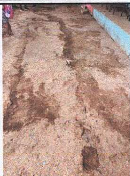
Foto 7: Se observa que la base del salon de usos multiples se encuentra en mal estado con imperfecciones, y rajaduras por temblores
