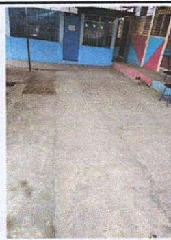
Foto 8: se observa que el salon de usos multiples no cuenta con piso adecuado para una mejor presentacion, y se quiere subir un poco la anivelacion
