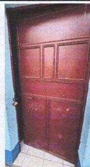
Foto 8: Se observa que la puerta requiere mantenimiento.
