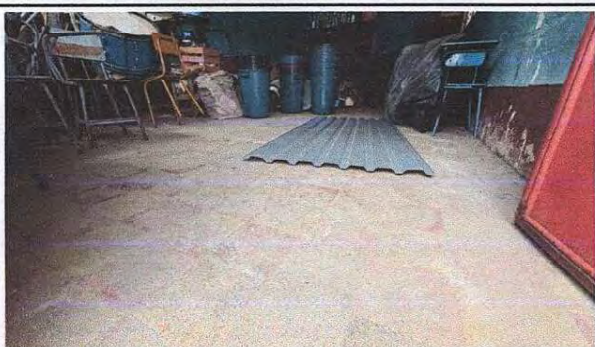
Foto 1: Se observa en mal estado el piso de granito.
