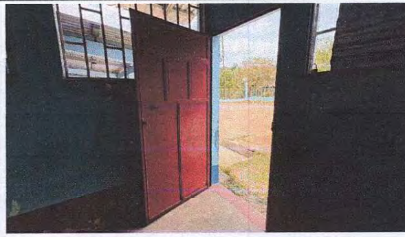
Foto 4: Se observa que la puerta se encuentra en mal estado.
