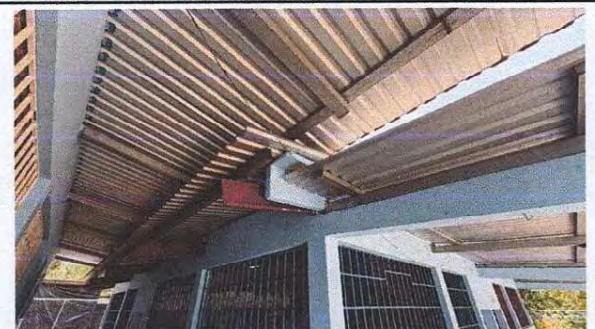
Foto 5: Se observa que se requiere de canal para el desfogue del agua pluvial.
