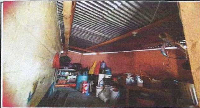
Foto 1: Se observa en mal estado las láminas, por lo que se sustituirá por lámina troquelada.
