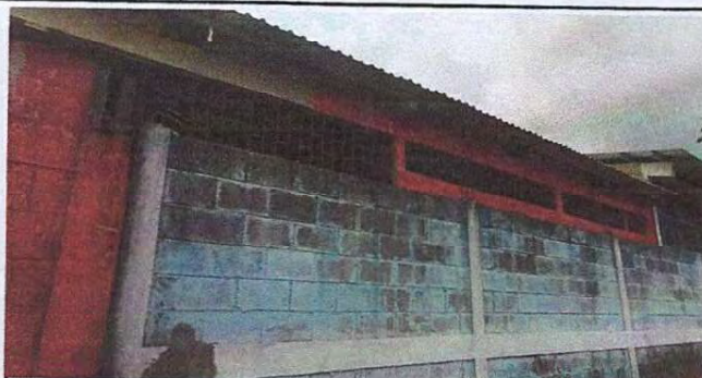
Foto 8: Se observa que el muro perimetral está en malas condiciones, por lo que se repellará por la parte inferior, para más duración.
