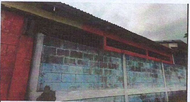
Foto 9: Se observa que en la parte inferior del muro perimetral esta descolorido, por lo que después de repellar se aplicará pintura latex.
