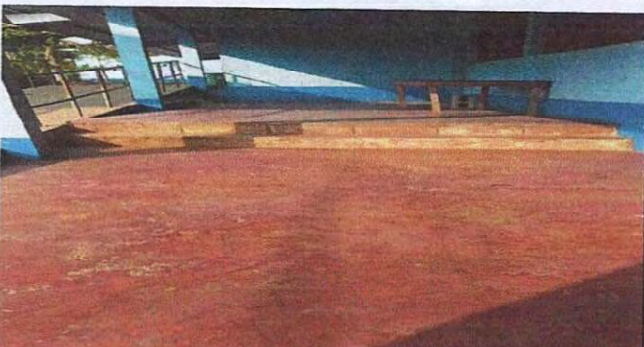
Foto 10: Se observa que el pasillo no cuenta con piso de granito, por lo que se le instalará.
