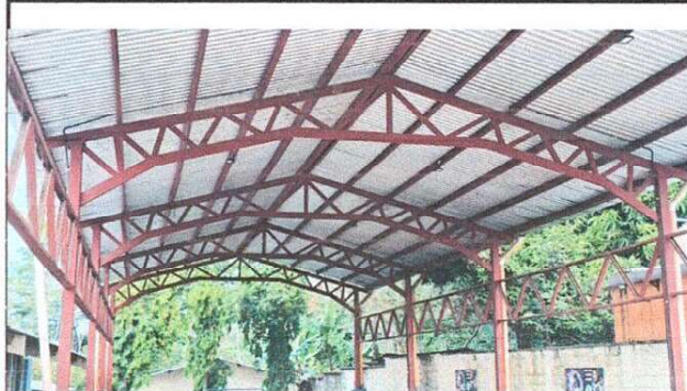
Foto 4: Se observa que la estructura necesita mantenimiento
