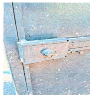
Foto 8: Aca se observa que se necesita sustituir la chapa de las puertas de las aulas
