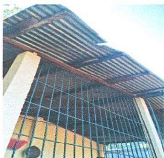
Foto 7: Aca se puede observar que se necesita sustituir la lámina en el área de la cocina
