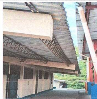
Foto 2: Se observa que falta instalación de canales en las láminas
