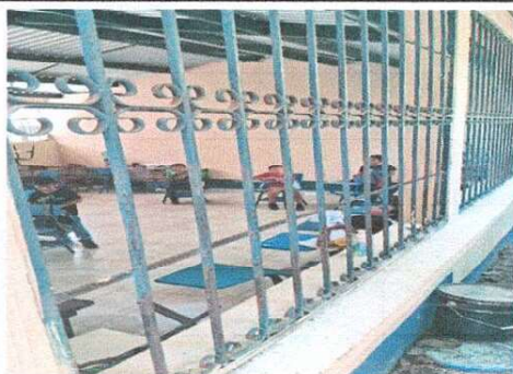
Foto 3: Se observa que la baranda necesita mantenimiento
