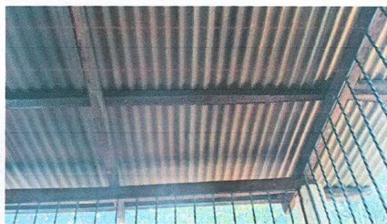
Foto 9: Aca se observa que se necesita sustituir el soporte de madera por soporte de metal
