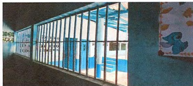
Foto 8: Se observa la necesidad de cambiar el balcon debido al mal estado
