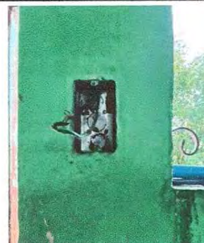
Foto 10: Se observa el mal estado del sistema eléctrico
