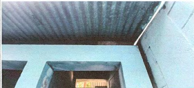
Foto 19: Se observa la necesidad de cambiar la lamina existente debido al mal estado
