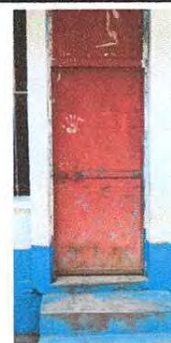
Foto 6: Se observa el mal estado de la puerta
