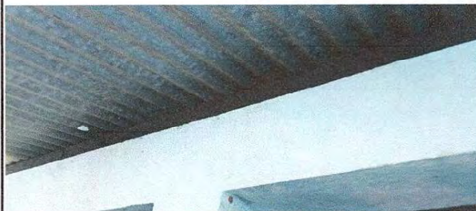
Foto 20: Se observa la necesidad de cambiar la estructura de metal debido al mal estado
