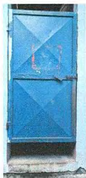
Foto 21: Se observa el mal estado de las puertas de metal
