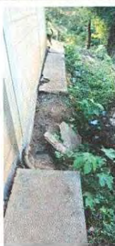
Foto 9: Se observa el mal estado de la banqueta de concreto
