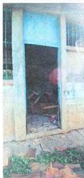
Foto 7: Se observa la necesidad de sellar con block la puerta
