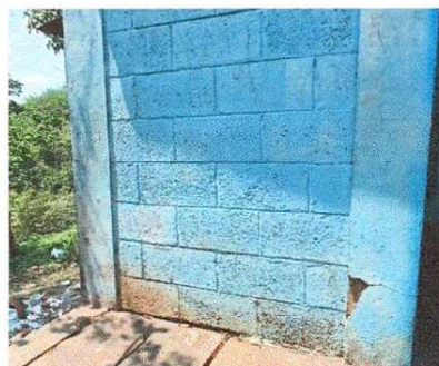
Foto 4: Se observa la falta de estación de lavado para limpieza de los niños.
