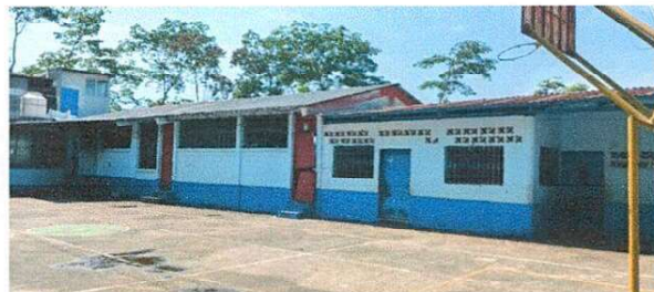
Foto 2: Se observa que se requiere mantenimiento de pintura interior y exterior
