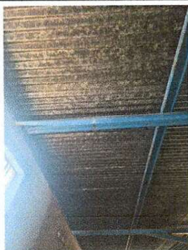
Foto 3: Se observa soporte de metal con falta de mantenimiento
