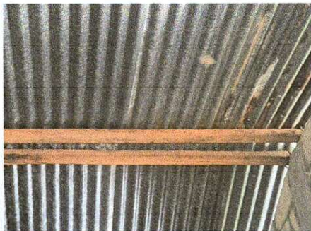
Foto 1: Se observa lámina de aulas en mal estado
