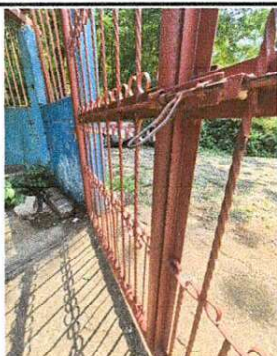
Foto 7: Se observa portón con falta de mantenimiento
