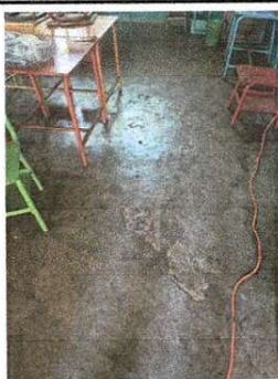
Foto 5: Se observa piso en mal estado y sin cerámico
