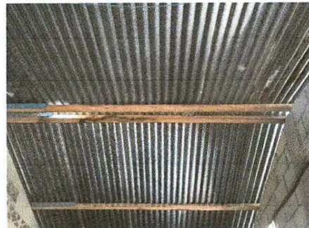
Foto 2: Se observa sección de soporte con estructura de madera y en mal estado
