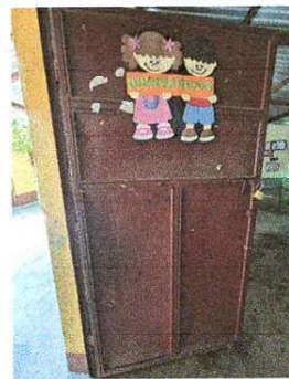
Foto 4: Se observan puertas en mal estado y avanzada corrosión
