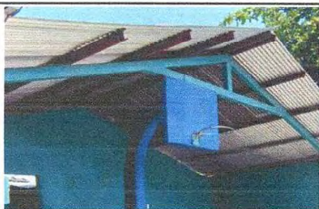
Foto 15: Se observa que la estructura de soporte del escenario requiere mantenimiento.
