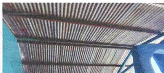
Foto 14: Se observa que la lámina del escenario se encuentra en malas condiciones.
