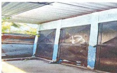
Foto 7: Se observa que las puertas se encuentran en mal estado.
