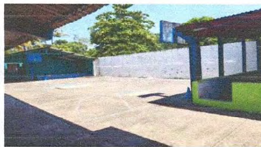
Foto 4: Se observa que la pintura del muro requiere mantenimiento.
