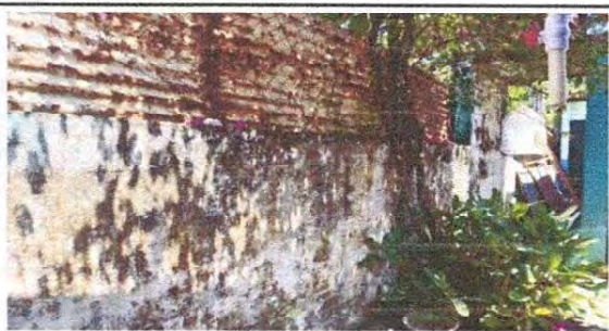
Foto 3: Se observa que el muro no cuenta con cernido.
