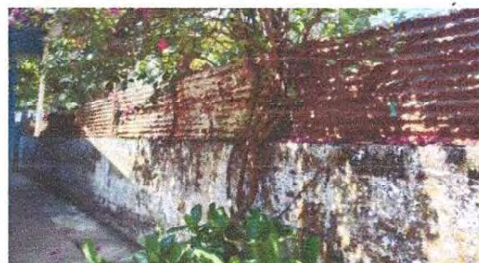
Foto 2: Se observa que el muro cuenta con humedad debido a la falta de repello.
