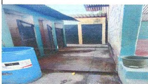
Foto 6: Se observa que no se cuenta con piso cerámico en baños.
