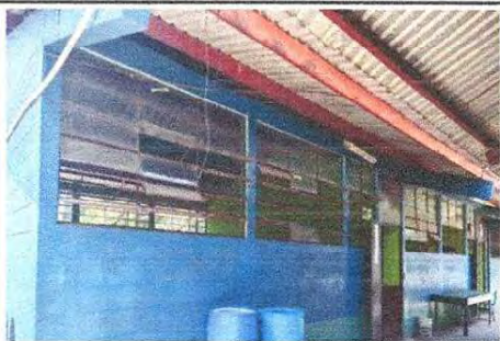
Foto 13: Se observa que los balcones de aulas requieren de mantenimiento.
