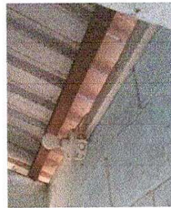
Foto 10: Se observa la necesidad de sustituir el sistema electrico en mal estado
