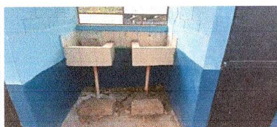
Foto 6: Se observa la necesidad de cambiar los lavamanos por una estacion de lavado para uso de los niños
