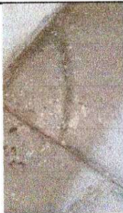
Foto 11: Se observa el mal estado del piso por lo que se desea cambiar por piso ceramico
