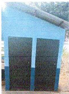
Foto 3: Se observa la necesidad de darle mantenimiento a las puertas de metal
