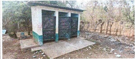
Foto 8: Se observa la necesidad de pintar muros interiores y exteriores
