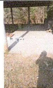
Foto 12: Se observa la necesidad de colocar piso ceramico
