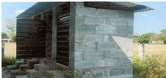
Foto 1: Se observa el mal estado de los sanitarios, son aboneros.
