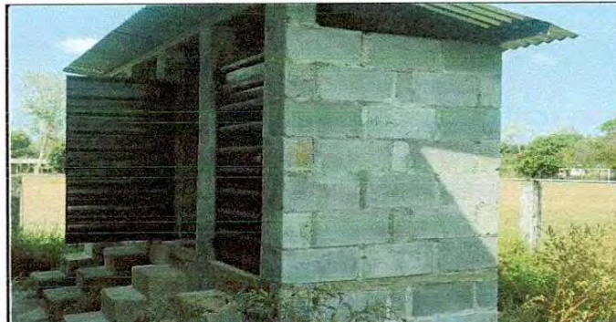
Foto 11: falta de repello en los sanitarios, instalacion de tubería Pvc de aguas negras,
