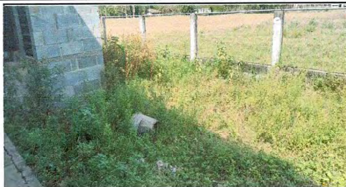
Foto 2: Se observa que no hay Fosa septica.
