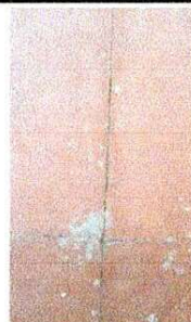
Foto 2: Se observa en mal estado del piso
