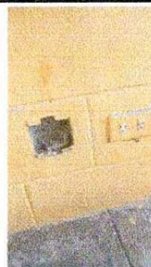
Foto 4: Se observa la necesidad de sistema eléctrico en las aulas de parvulos
