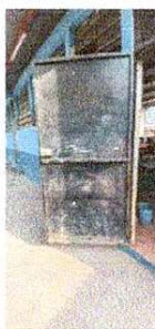
Foto 3: Se observa la necesidad de cambiar puerta en aula
