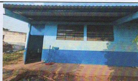
Foto 22: Se observa la falta de puerta valcon en aula de parvulos.
