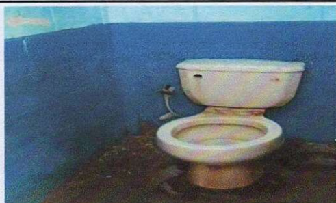
Foto 11: Se observa Inodoro en mal estado
