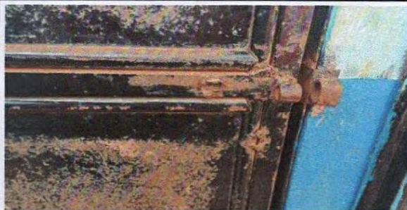
Foto 34: Se observa puerta de metal en mal estado.
