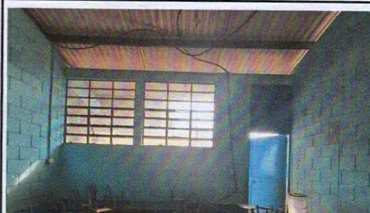
Foto 20: Se observa sistema electrico en mal estado
