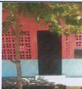
Foto 23: Se observa la falta de puerta valcon ya que los niños se salen y corren peligro
