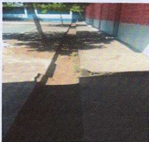
Foto 31: Se observa falta de rejilla
