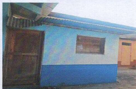
Foto 2: Se observa que la lamina esta en mal estado y se cambiara por lamina troquelada.
