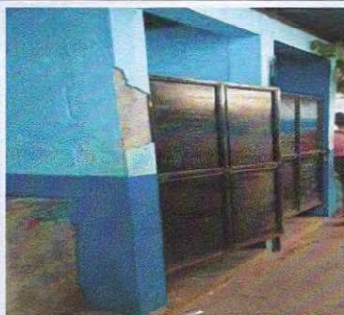
Foto 7: Se observa que las puertas de los baños no cuentan con Chapa
