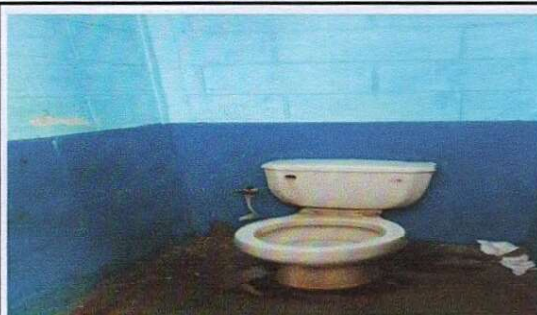
Foto 16: Se observa que las paredes de los baños no tienen Azulejo.
