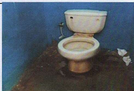
Foto 15: Se observa que el piso de los baños no cuenta con piso Ceramico
