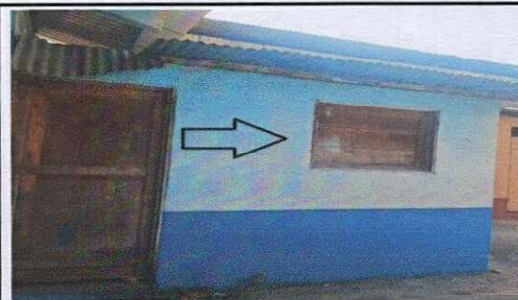
Foto 6: Se observa la falta de valcon de metal
