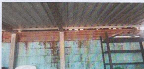
Foto 27: Se observa estructura muy baja nesecita reparacion
