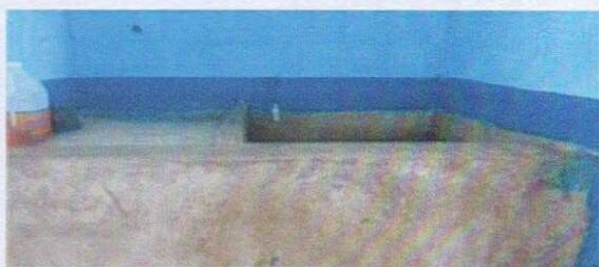
Foto 29: Se observa falta de azulejo en tanque
