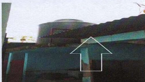
Foto 9: Se observa que la costanera del techo se encuentra en mal estado
