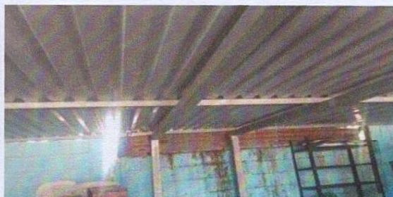
Foto 28: Se observa falta de mantenimiento en techo de comedor
