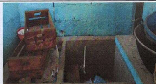
Foto 18: Se observa falta de azulejo en tanque
