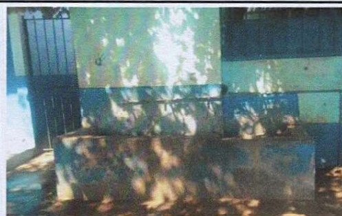
Foto 14: Se observa la falta de azulejo en lavamanos.
