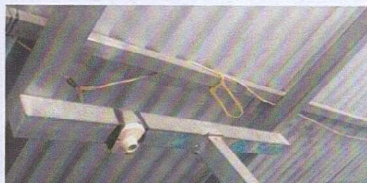
Foto 26: Se observa sistema electrico en mal estado
