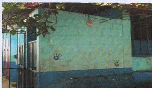
Foto 13: Se observa que las paredes de los baños requiera aplicación de pintura
