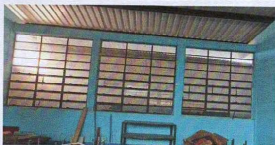
Foto 19: Se observa que es necesario sustituir los balcones ya que el aula tiene vidrios quebrados
