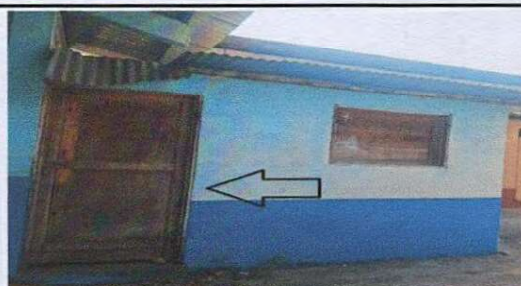
Foto 4: Se observa que la puerta de madera se encuentra en mal estado
