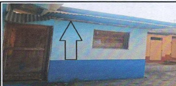
Foto 3: Se observa que la madera del techo se encuentra en mal estado
