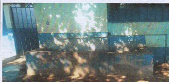
Foto 32: Se observa falta de torta de concreto
