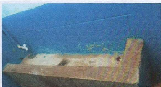
Foto 17: Se observa falta de azulejo en mingitorio
