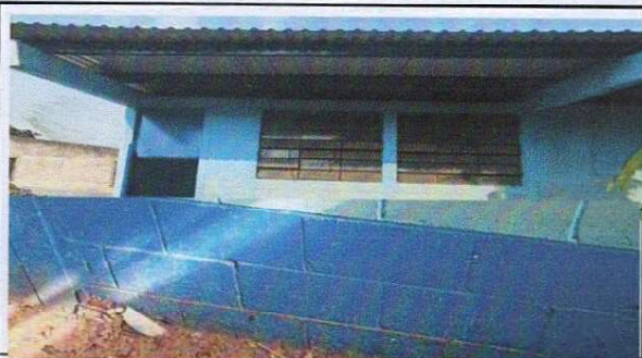
Foto 21: Se observa el daño ocasionado por palomas es importante sellar el ingreso con malla
