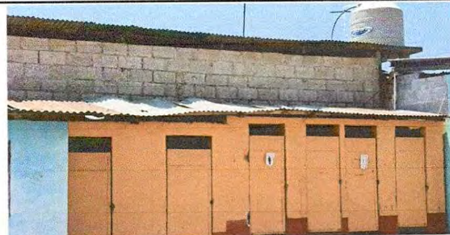
Foto 6: Se observa que es necesario sustituir la lamina de los sanitarios por lamina troquelada
