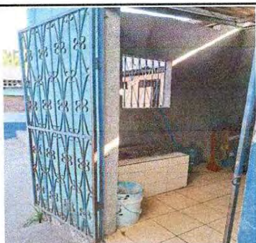
Foto 5: Se observa que es necesario el suministro e instalación de puerta porque la cocina no cuenta con puerta segura.
