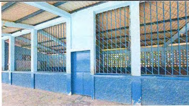
Foto 15: Se observa que es necesario mantenimiento de 5 balcones de modulo 1 aulas
