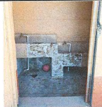
Foto 12: Se observa que se necesita dar mantenimiento a mingitorio de azulejo y concreto.
