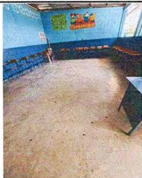
Foto 21: Se observa que es necesario el suministro e instalación de piso cerámico en 3 aulas del modulo 4
