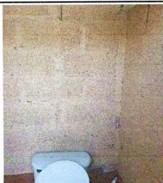
Foto 9: Se observa que es necesario repellar el muro interior pues el block es de poma.
