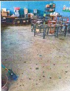
Foto 17: Se observa que es necesario el suministro de piso cerámico del modulo 2 aulas
