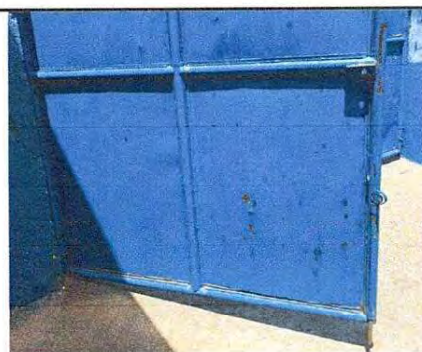
Foto 24: Se observa que el portón de la entrada principal necesita mantenimiento por presentar corrosión.
