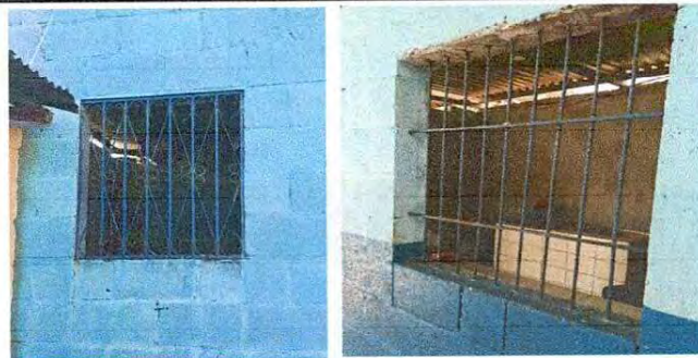
Foto 4: Se observa que es necesaria la instalación de 2 ventanas de PVC en la cocina
