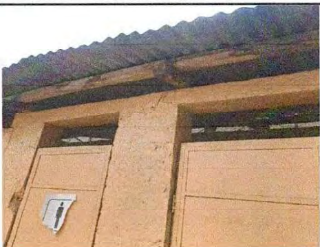
Foto 7: Se observa la madera debe cambiarse por estructura de metal.
