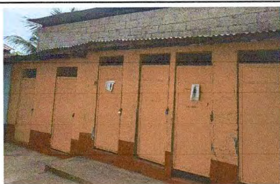
Foto 8: Se observa que es necesario la sustitución de puerta exterior de servicios sanitarios.
