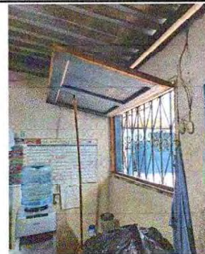
Foto 22: Se observa que es necesario sustituir la ventana de madera por ventana de PVC
