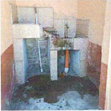
Foto 13: Se observa que es necesaria la reparación de lavamanos de concreto y azulejo
