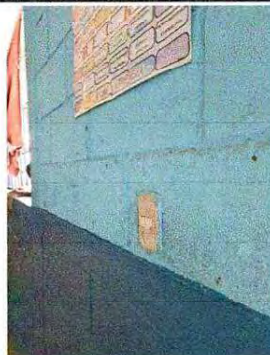
Foto 20: Se observa que es necesario la reparación de sistema eléctrico en 3 aulas del modulo 4
