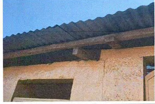
Foto 14: Se observa que es necesario el tallado de mojinete.
