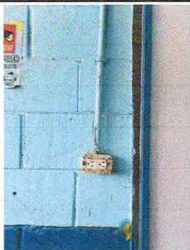
Foto 19: Se observa que se necesita suministro e instalación de sistema eléctrico en 4 aulas modulo 3
