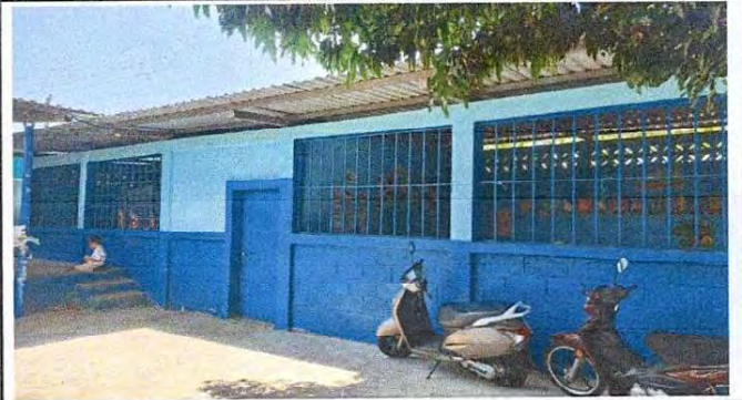
Foto 16: Se observa que es necesario mantenimiento de 4 balcones modulo 2 aulas
