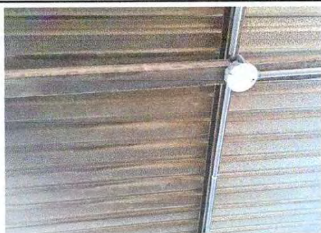
Foto 23: Se observa que la lamina de modulo Dirección y Cocina necesita mantenimiento.
