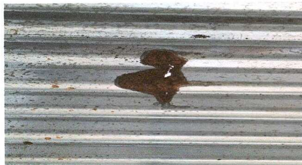
Foto 4: Se observa que la lamina se encuentra en mal estado de los baños
