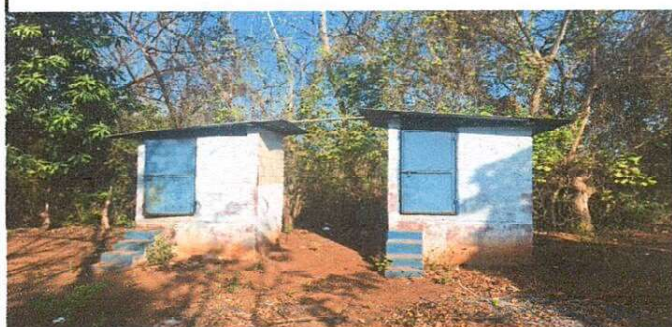
Foto 3: Se observa los inodoros en mal estado, urge sustituirlos
