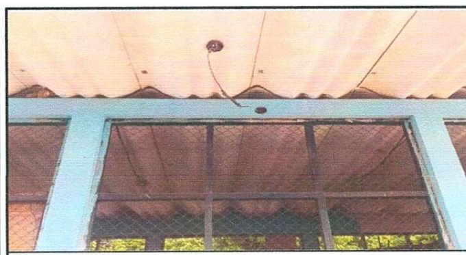
Foto 5: Soporte de estructura de metal
