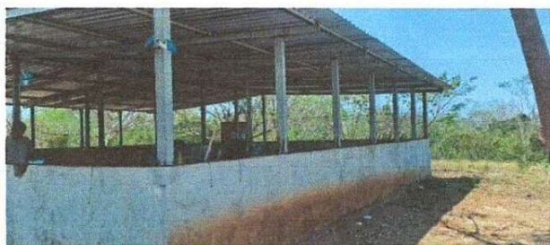
Foto 1: Se observa mal estado de malla, urge sustituirla.
