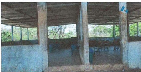
Foto 3: Se observa que falta puerta principal, urge suministro e instalación de puertas.
