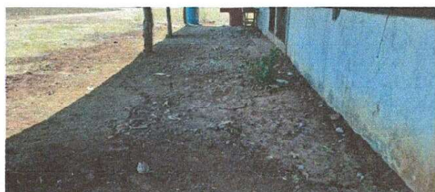
Foto 5: Se observa falta de piso, urge suministro e instalación de torta de cemento.
