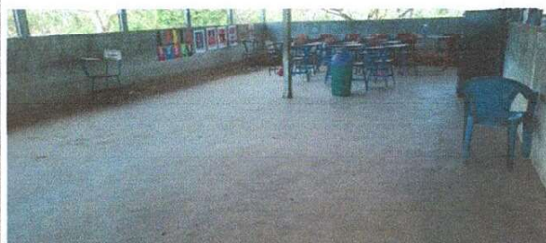
Foto 4: Se observa piso en mal estado, urge suministro e instalación de piso cerámico.
