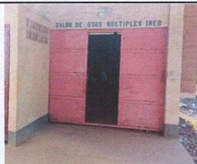
Foto 6: Se observa que el portón del salón está deteriorado, requiere mantenimiento.
