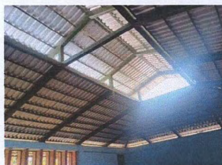
Foto 4: Se observa los espacios del techo del salón, donde ingresan las aves, se requiere la protección de cedazo metálico.
