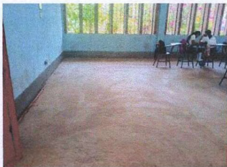
Foto 3: Se observa el piso de concreto en el salón de usos múltiples, se requiere la sustitución por piso cerámico.
