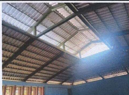
Foto 5: Se observa los espacios del techo del salón, donde ingresan las aves, se requiere la protección de cedazo metálico.
