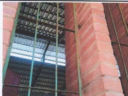
Foto 8: Se puede observar que los balcones requieren de mantenimiento.
