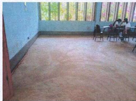
Foto 4: Se observa el piso de concreto en el salón de usos múltiples, se requiere la sustitución por piso cerámico.
