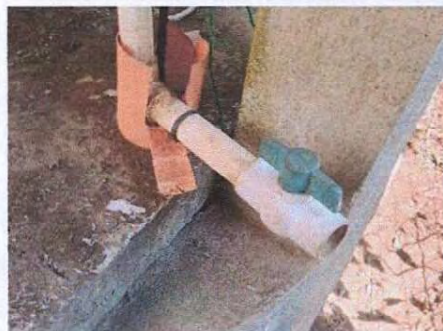
Foto 2: Se observa que la bomba del pozo que provee agua a todo el plantel está dañada.
