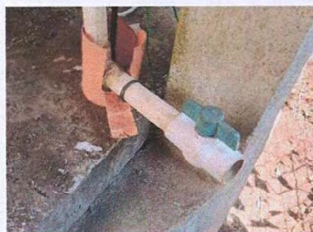
Foto 2: Se observa que la bomba del pozo que provee agua a todo el plantel, esta dañada y no tiene reparación, por lo que se requiere el suministro e instalación de una nueva.
