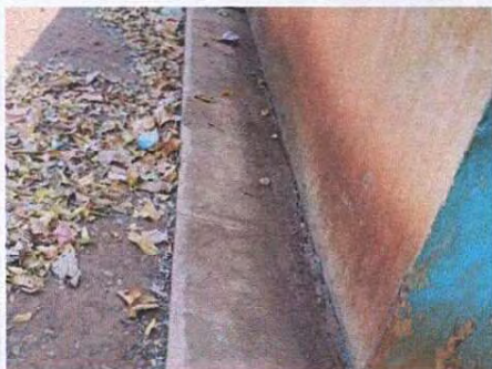
Foto 1: Se observa el deterioro de la pintura de los muros del plantel en general.
