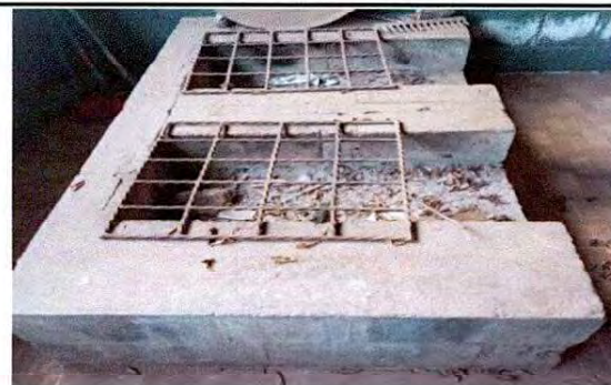
Foto 18: Se observa la estufa rural deteriorada.
