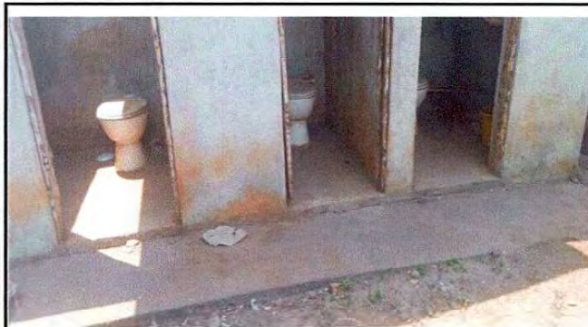
Foto 8: No se observa azulejo en sanitarios
