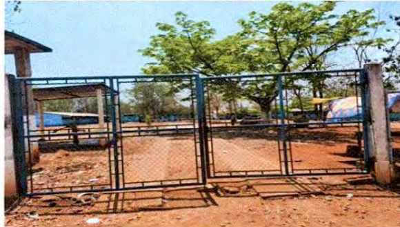
Foto 22: Se observa el portón del establecimiento educativo en mal estado.
