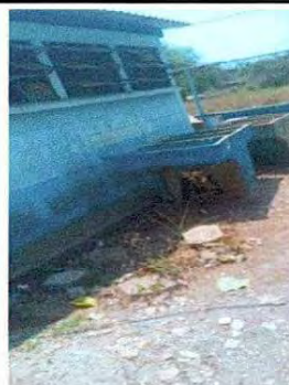
Foto 4: No se observa base de cemento para instalación de pila de dos lavaderos, se realizará sustitución de pila.
