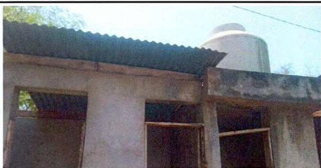
Foto 11: Depósito de agua en mal estado.
