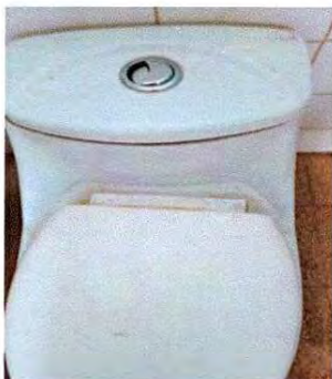
Foto 1: Se observan 4 sanitarios en mal estado.
