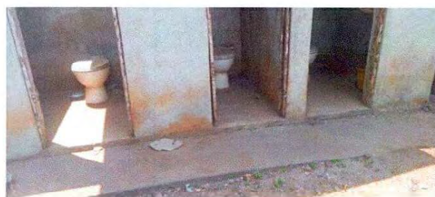
Foto 16: Falta de piso cerámico en los sanitarios
