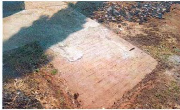
Foto 20: Se observa la plancha de concreto en corredor deteriorada.
