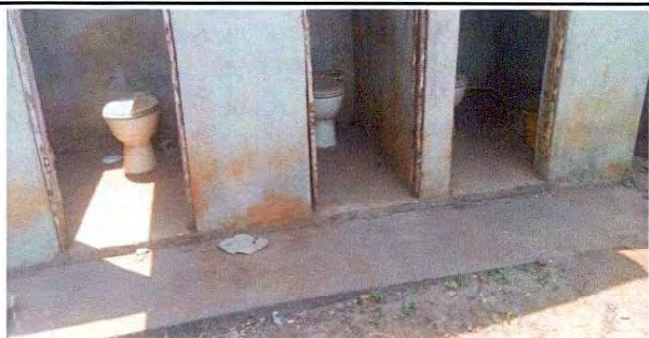
Foto 7: Se observa falta de lavamanos del módulo 2 y otros deteriorados.
