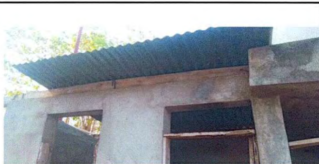
Foto 10: Falta de lamina y estructura de metal en módulo 2 sanitarios
