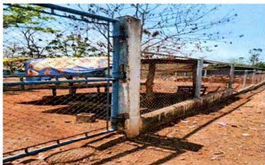
Foto 21: Se observan las columnas del portón de la escuela en mal estado.
