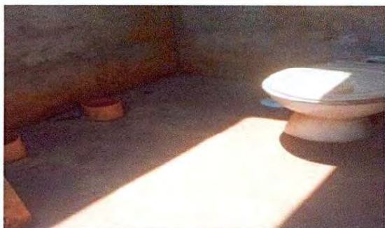
Foto 13: Se observa falta de tubería principal pvc agua
