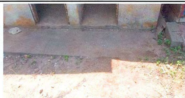
Foto 9: Se observa una banqueta en baños deteriorada.
