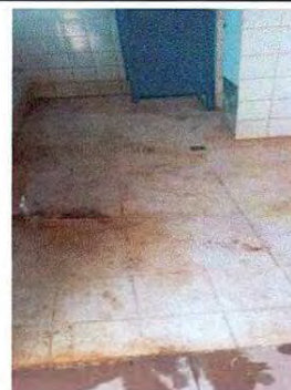
Foto 2: Se observa el piso cerámico en mal estado, por lo que se sustituirá por torta de cemento y cerámico
