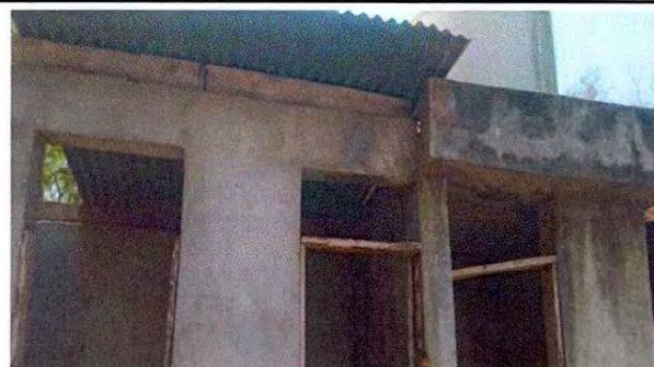
Foto 14: Falta de repello en paredes de sanitarios.
