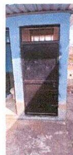
Foto 10: Se observa la necesidad de darle mantenimiento a las puertas
