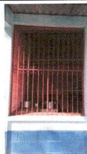
Foto 2: Se observa el mal estado del balcon de metal
