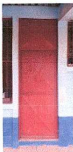
Foto 3: Se observa que las puertas necesitan mantenimiento
