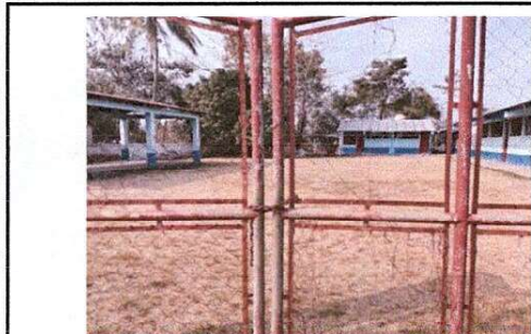
Foto 15: Se observa la necesidad de sustituir el porton debido al mal estado
