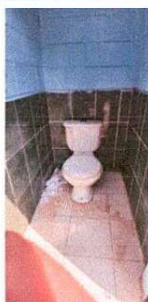
Foto 9: Se observa la necesidad de cambiar los inodoros
