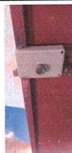
Foto 4 : Se observa la necesidad de colocar chapa en puerta
