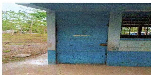
Foto 3: Se observa que la puerta de metal se encuentra en mal estado por lo que es necesaria su sustitución.
