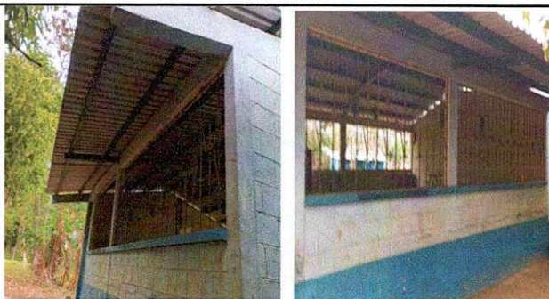
Foto 4: Se observa que es necesario el mantenimiento con pintura anticorrosiva en balcones de metal.
