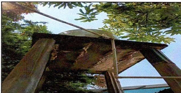
Foto 6: se observa que la llave de paso se encuentra en mal estado por lo que es necesaria su sustitución.
