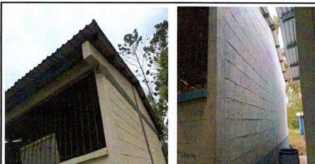
Foto 5: Se observa que es necesaria la aplicación de pintura latex acrilica en paredes ya que se encuentra deteriorada la misma..
