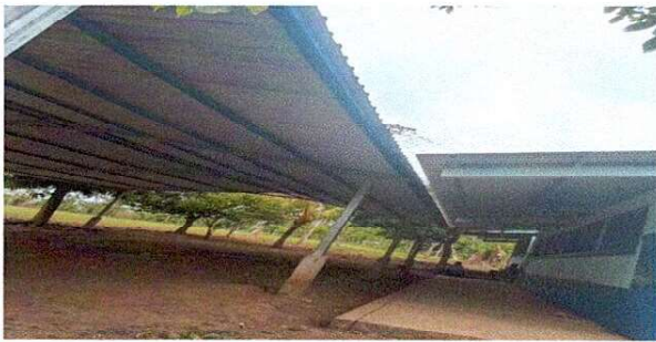
Foto 7: Se observa que es necesaria la instalación de canales pluviales en salón de usos múltiples.
