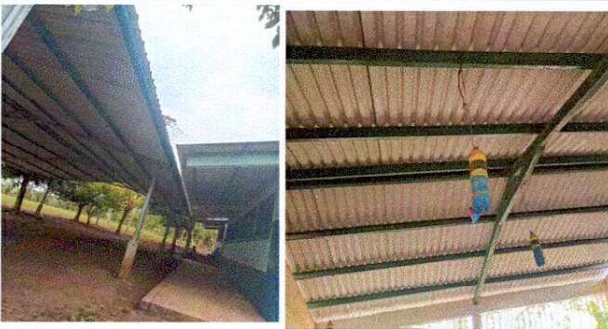
Foto 9: Se observa que es necesario el suministro y sustitución del sistema eléctrico en salón de usos múltiples y en módulo de aulas.
