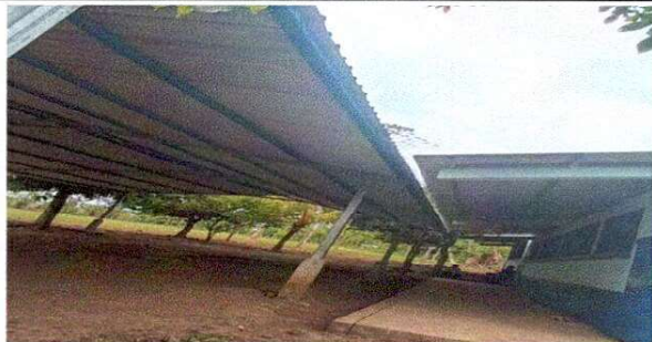
Foto 10: Se observa que es necesario el suministro del muro perimetral del salón de usos múltiples
