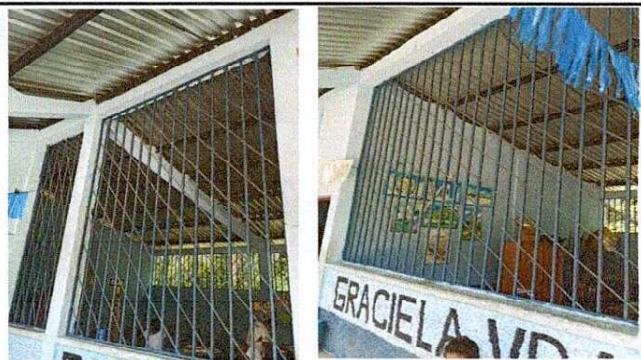
Foto 1: Se puede observar que los balcones de metal se encuentran en mal estado por lo que es necesaria su sustitución.
