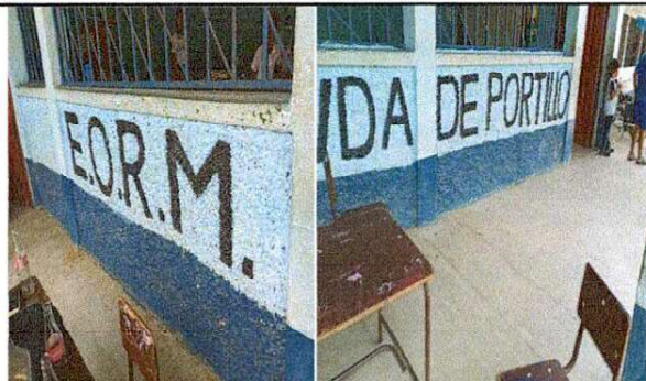
Foto 2: Se observa que es necesaria la aplicación de repello en paredes del módulo de aulas.
