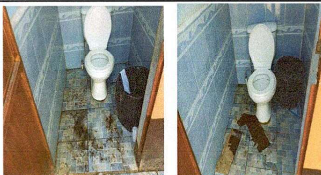
Foto 3: Se puede observar que los inodoros se encuentran en mal estado por lo que es necesario su sustitución.
