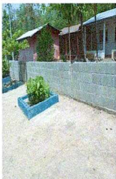
Foto 7: Se observa que es necesaria la aplicación de repello en paredes del muro perimetral.
