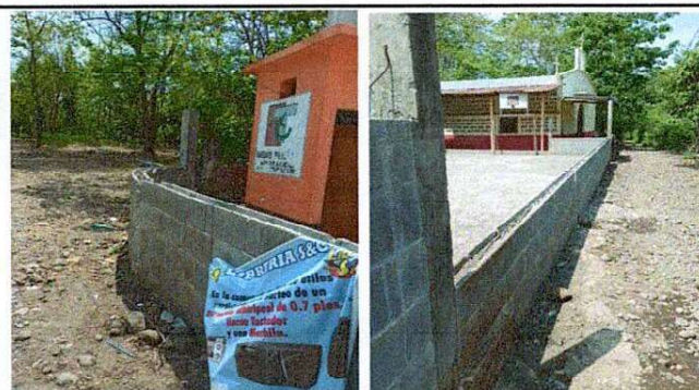
Foto 5: Se puede observar que es necesario el suministro y la instalación de verja de balconeria de metal en paredes perimetrales del establecimiento educativo.
