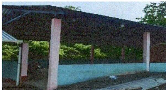
Foto 2: Se observa la ausencia de porton de ingreso del salon de usos multiples.
