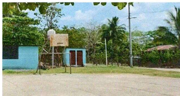
Foto 4: Se observa la ausencia de porton de ingreso de la escuela.
