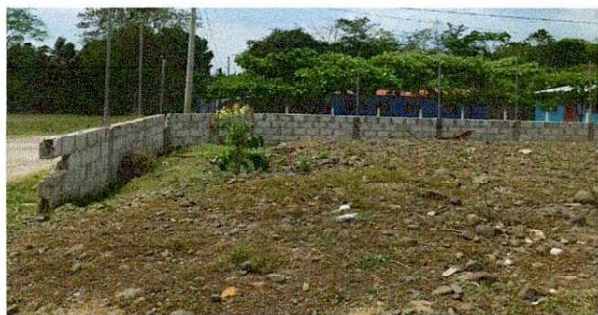
Foto 3: Se observa muro perimetral en mal estado, con una baja altura.
