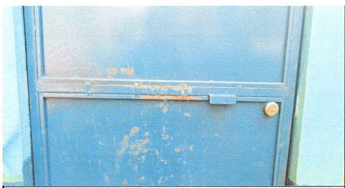
Foto 5: Se observa el deterioro de las puertas, necesitan mantenimiento.
