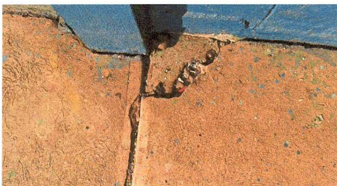
Foto 4: Se observa que la banqueta del módulo 1 se encuentra en mal estado, urge sustituirlo
