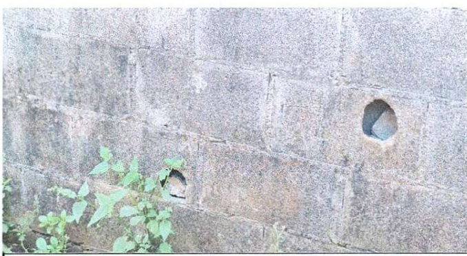
Foto 6: Se observa agujeros en el muro perimetral, se necesita resanar
