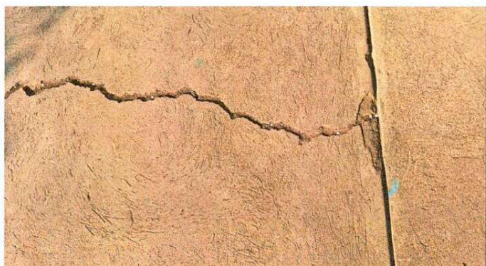
Foto 3: Se observa que el piso de las aulas se encuentra en mal estado, urge sustituirlo
