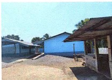
Foto 3: Se observa que se necesita el suministro y colocación de canal de metal, incluye bajada de agua de 3".
