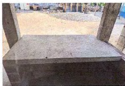
Foto 7: Se observa que es necesario el suministro e instalacion de azulejo.
