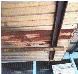
Foto 1: Se observa que es necesario proteger la cocina de filtración de agua por lo que se necesita sustitución de lamina por el deterioro de la misma.
