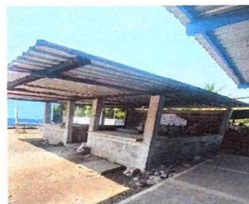
Foto 4: Se observa que se necesita el suministro e instalacion de ventanas de metal para proteger de las lluvias.
