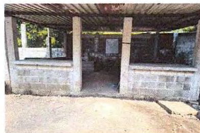
Foto 8: Se observa que es necesario el suministro de empedrado fraguado de 10 cm.
