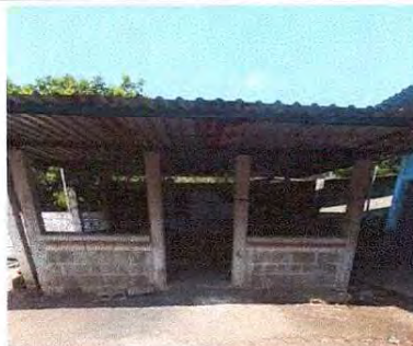
Foto 14: Se Observa deterioro en la pared por lo que necesita aplicar pintura.
