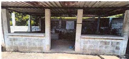
Foto 15: Se Observa agujeros en la pared por lo que se necesita resane de agujeros.
