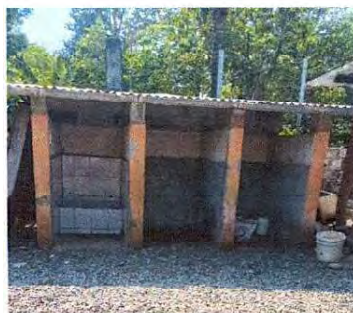
Foto 16: Se observa que no hay puertas por lo cual es necesario suministro e instalación.
