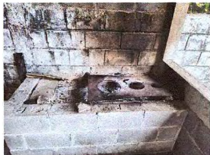
Foto 13: Se observa el mal estado de la estufa rural por lo cual se necesita mantenimiento o sustitución.
