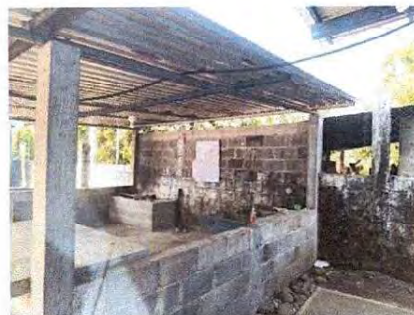
Foto 10: Se Observa que es necesario levantado de muro para proteccion de lluvias y seguridad de la cocina.
