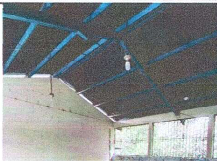
Foto 7: El cableado de sistema Electrico se encuentra ya en mal estado y se necesita ya hacer cambio.
