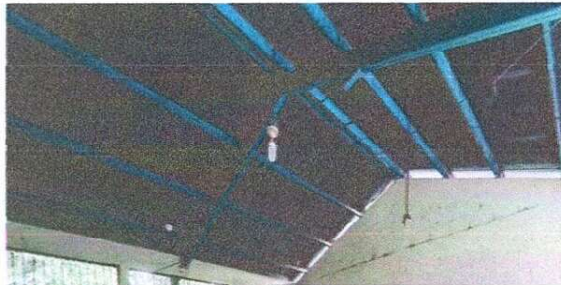
Foto 2: se observa que la estructura de soporte de metal, necesita mantenimiento preventivo y correctivo.
