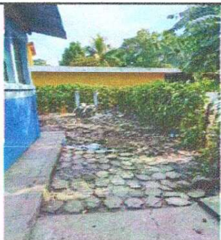
Foto 9: El fraguado de areas de descanso se encuentra en mal estado, se necesita realizar una torta de concreto mejorada.
