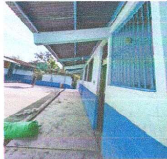
Foto 4: se observa que carece de canal para recibir el agua de lluvia.
