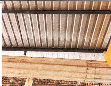
Foto 1: Se observa el mal estado de la estructura
