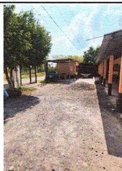
Foto 4: Se observa falta de piso de concreto en patios
