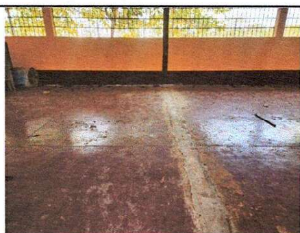
Foto 5: Se observa piso deteriorado
