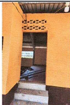
Foto 2: Se observa la falta de puerta en salón
