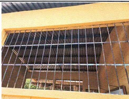
Foto 3: Se observa balcones deteriorados
