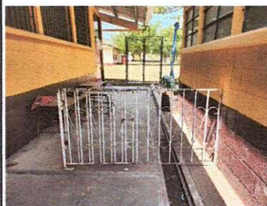
Foto 8: se observa baranda en mal estado
