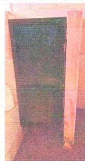
Foto 6: Se observa deterioro fisico en puertas de ingreso de baños.
