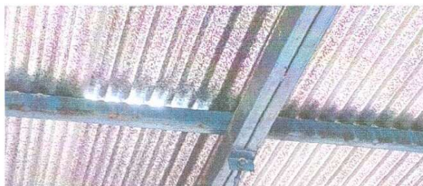
Foto 2: Se observa deterioro en la estructura metalica
