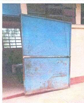
Foto 4: se observa destruccion de los puntos de sujecion de puerta de salon de aula, modulo 4.
