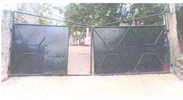
Foto 5: Se observa deterioro fisico del porton de ingreso principal de la escuela, no funciona el abatimiento.
