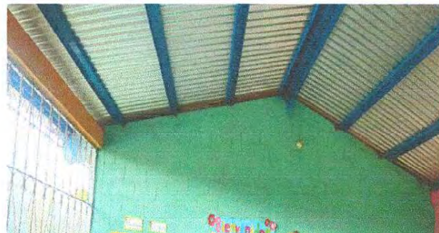
Foto 4: Se observan que en las aulas carecen de energía eléctrica del Modulo I
