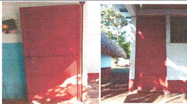
Foto 13: Se observa que es necesario mantenimiento de puertas en aula del modulo V
