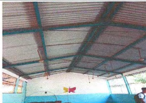
Foto 14: Se observa que las aulas carecen de energía eléctrica del modulo V
