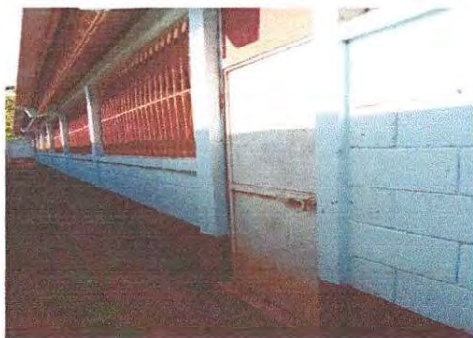
Foto 3: Se observa que es necesario mantenimiento de puerta en aula del modulo I
