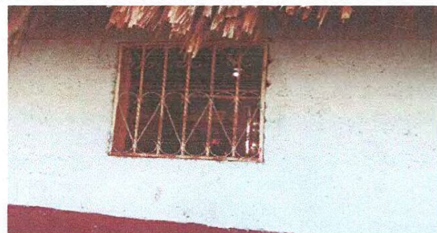
Foto 6: Se observa que es necesaria la ampliación de ventana y cambio de balcon de metal modulo IV
