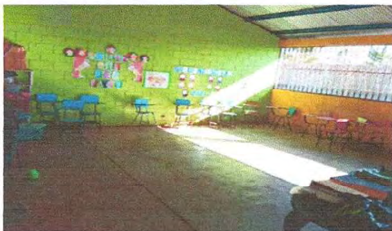
Foto 1: Se observa que el piso de modulo I esta en mal estado es necesario su sustitucion en aulas existentes
