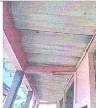
Foto 2: Se observa que no cuenta con estructura metálica
