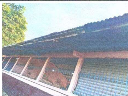
Foto 4: se observa deterior físico en las costaneras de la cubierta
