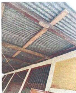
Foto 5: Se observa que en aulas puras carecen de viga de moginete
