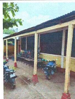
foto 4: Se observa que patio carece de torta de concreto
