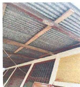
Foto 2: Se observa mal estado de estructura soporte de madera
