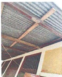
Foto 1: Se observa lámina con deterioro físico
