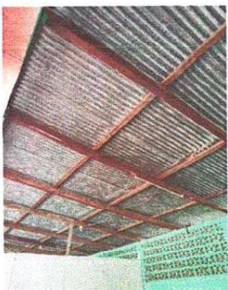
Foto 3: Se observa que aulas no cuenta con accesorios eléctricos
