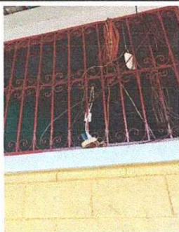
Foto 7: Se observa que aulas no cuenta con accesorios eléctricos
