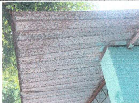
Foto 2: Se observa corrosión en el techo del módulo 1.
