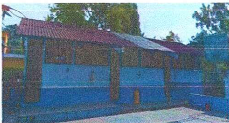
Foto 9: Se observa que el techo de las aulas se encuentra en mal estado y necesita suministro e instalación de lámina.
