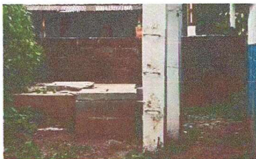
Foto 1: Se observa columnas expuestas y grietas a lo largo de todo el muro, por lo que es necesario sustitución
