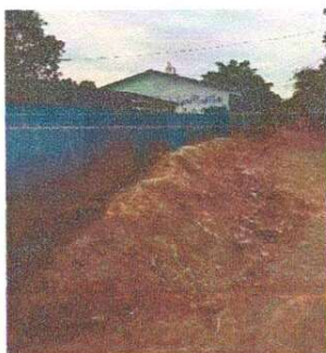
Foto 3: Se observa deterioro en la pared por lo que se necesita aplicar pintura.
