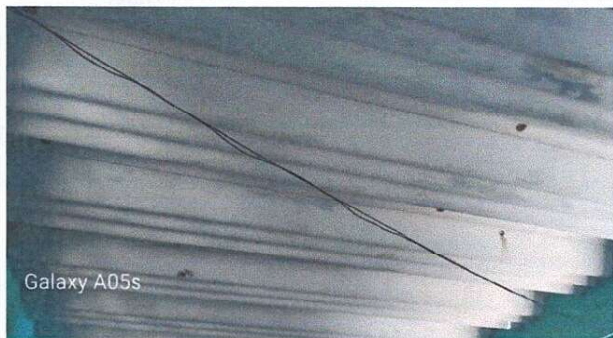
Foto 1: Se observa en mal estado la teja cambio de lámina y estructura metálica
