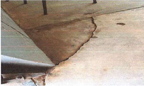
Foto 1: Se observa el piso dañado con fisuras y grietas
