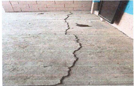
Foto 2: Se observa daño en la plancha del corredor
