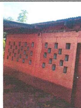
Foto 4: Se observa que el salon de clases no cuenta con ventanas.
