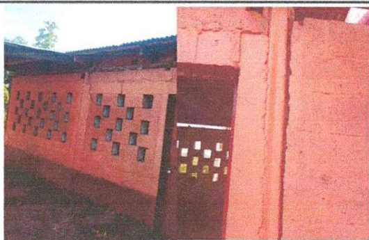
Foto 3: Se observa el muro de cerramiento del aula con fisuras y grietas profundas, con vulnerabilidad de caerse
