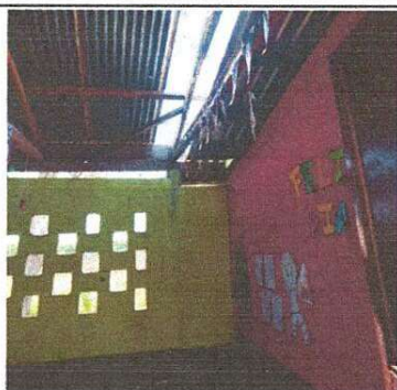
Foto 7: se observa deterioro de pintura en el interior del salon de clases.
