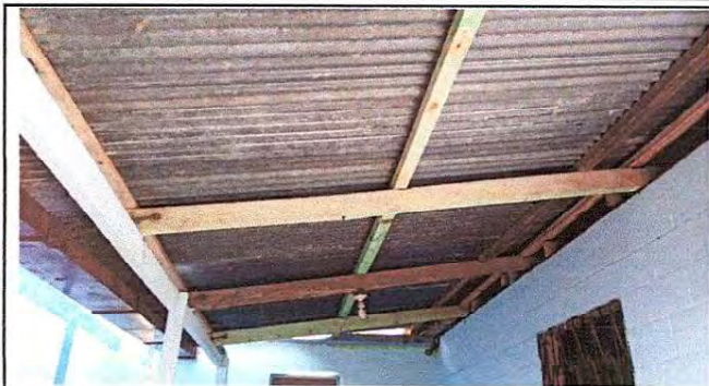
Foto 7: Se observa que la estructura portante de madera se encuentra en mal estado. Por lo que se requiere de cambio por estructura portante de metal.
