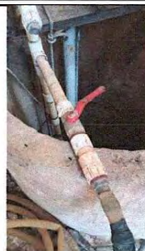
Foto 14: Se observa que la llave se encuentra en mal estado.
