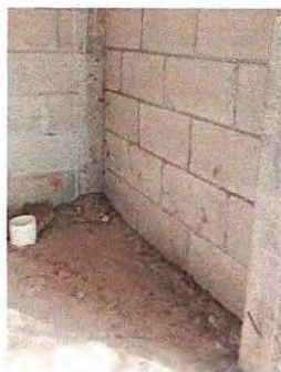
Foto 13: Se observa que es necesario la instalacion de azulejo en servicio sanitario
