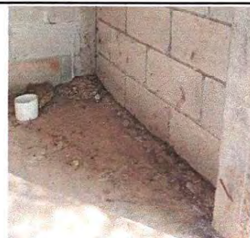
Foto 10: Se observa que es necesario la instalacion de piso ceramico
