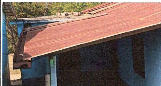
Foto 8: Se observa que los canales de bajada pluvial se encuentra en mal estado.
