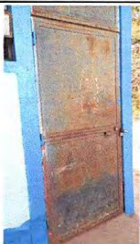
Foto 1: Se observa la puerta del salón que está en mal estado.
