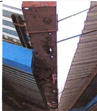
Foto 2: Se observa que los canales de bajada pluvial se encuentran en mal estado.
