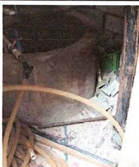
Foto 15: Se observa que el area de pozo no cuenta con torta de concreto.
